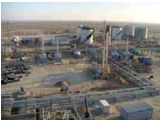
Zăcămintul Komsomolskoe (Instalația Centrală de Procesare)
